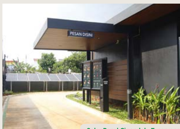
Solar Panel Cipondoh, Tangerang
